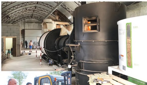
Оборудование пеллетного цеха.
